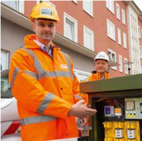
Vernetzte Trafostation: Messgeräte sammeln Daten und funken sie über das LoRaWAN-Netz in Monitoring-Systeme.
